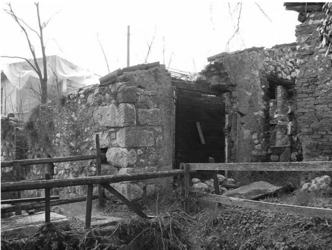
Il prospetto sud, verso il Rudone, con il bell'angolare medievale. Purtroppo le spallette in marmo di Botticino erano state rubate, e sono state rifatte in mattoni.
