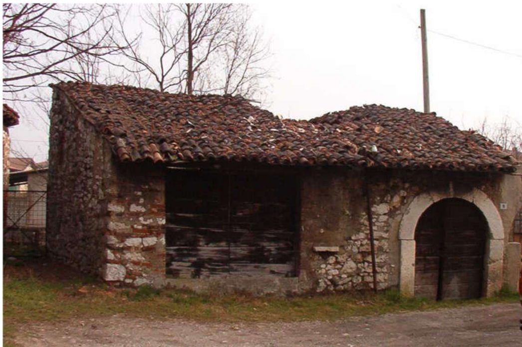
L'ingresso alla fucina dopo il crollo del tetto
